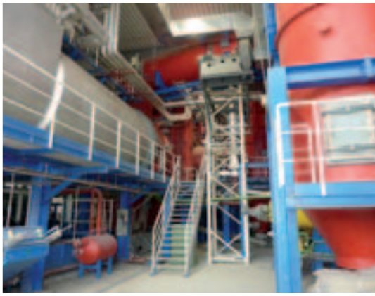
Biomassenkraftwerk bei Richi AG
